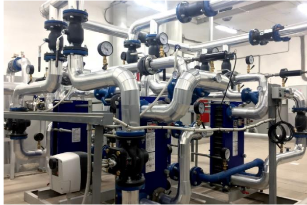
ЖКХ, ИТП, ЦТП
